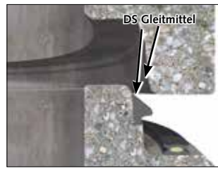
Beispiel: lose Schachtdichtung
